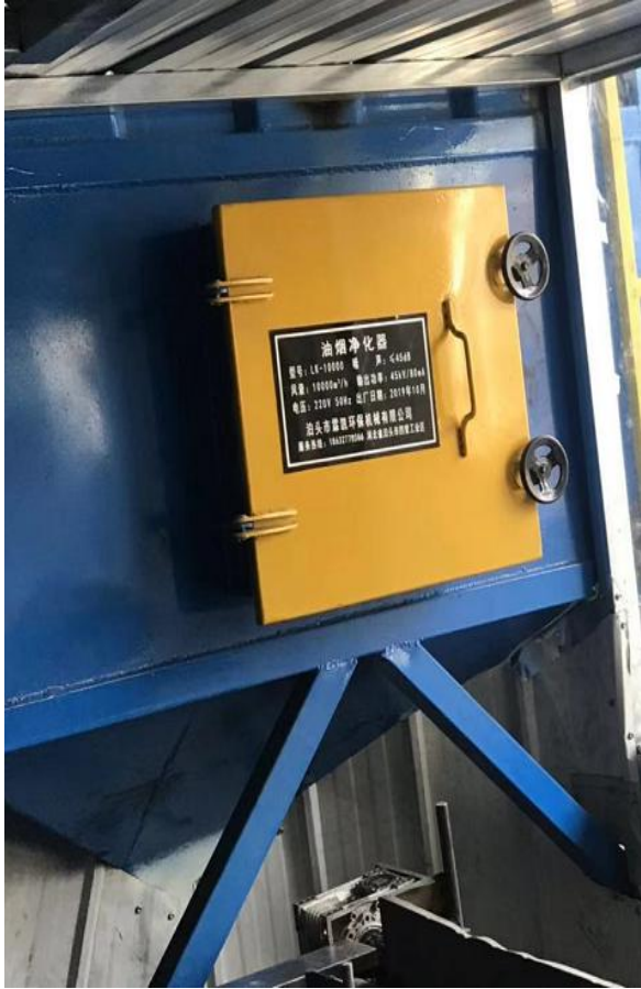
烘干炉设备油气净化装置
