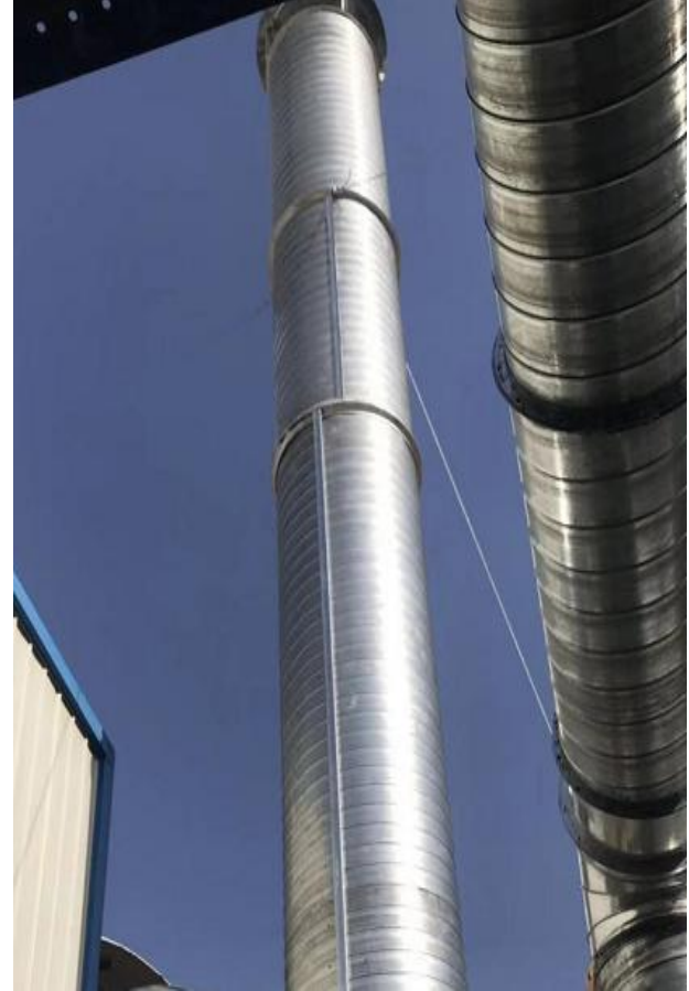
项目喷漆废气排气筒
