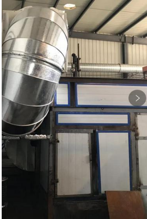
项目封闭式喷漆车间和废气收集管道
