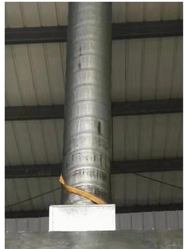
热熔废气排气筒
