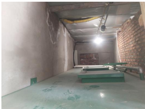
一体化污水处理设施
