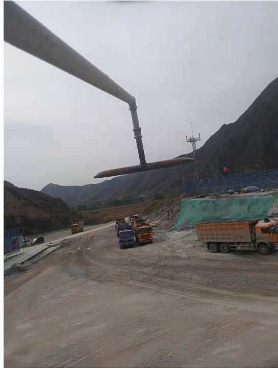
加工区洒水喷淋装置
