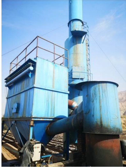
布袋除尘器+湿式除尘脱硫塔
