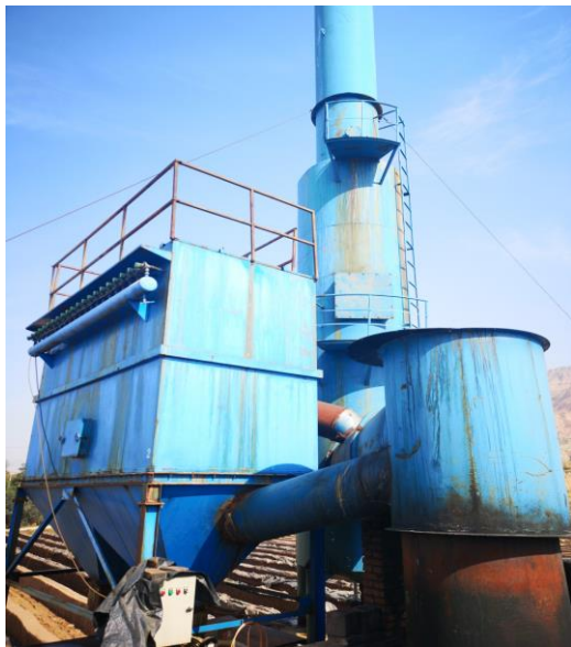
布袋除尘器+湿式除尘脱硫塔
