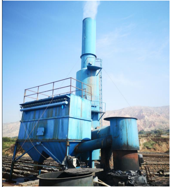
湿式除尘脱硫塔
