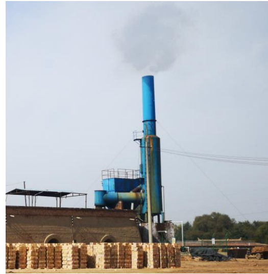
湿式除尘脱硫塔+15m 高排气筒
