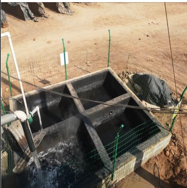
湿式除尘脱硫塔循环水池
