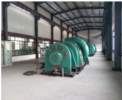
水电站发电厂房内景
